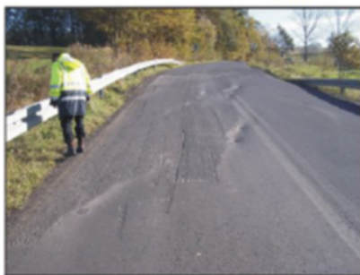
Fot.1. Widoczne odkształcenia nawierzchni po sfrezowaniu
