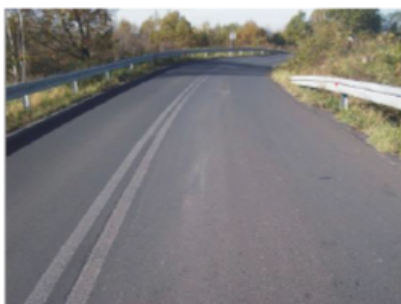
Fot.3. Uszkodzenia podłużne nawierzchni na łuku drogi
