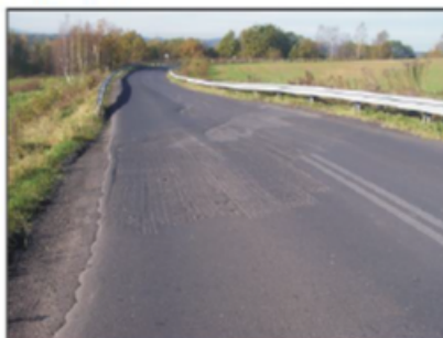
Fot.2. Widoczne uszkodzenia i ugięcia nawierzchni na całym odcinku osuwiska nr 1
