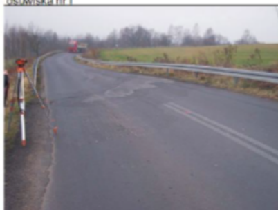
Fot.4. Uszkodzenie nawierzchni na 2-ch pasach jezdni
